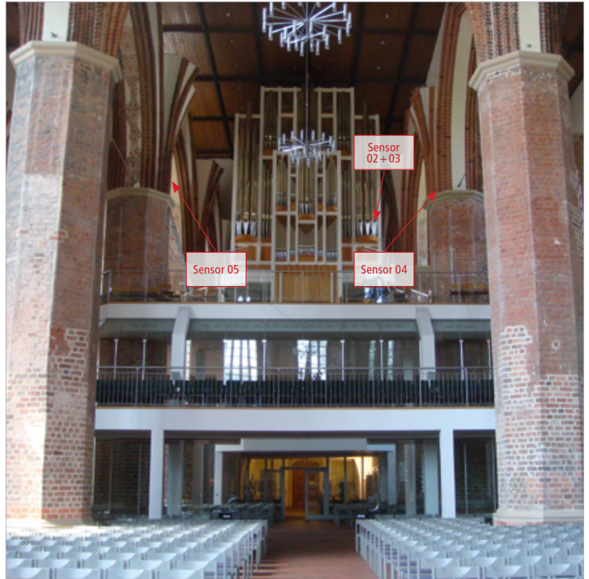
Sensoren 04 und 05 an den Pfeilerköpfen, Sensoren 02 und 03 an der Tragkonstruktion der Orgel (einaxial)
